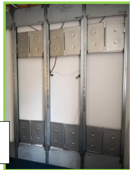
Offene Wärmewand mit Heizregister und Speicherboxen
