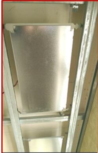
Offene Wärmdecke mit Heizboxen
